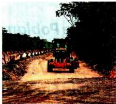
Algunos pagos en exceso en obras del Tren Maya son en terraplenes, pasos vehiculares y rellenos.
