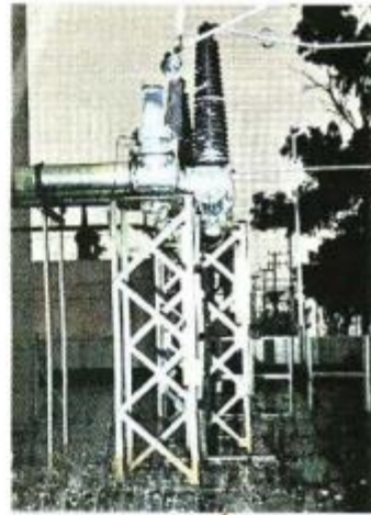
La CFE aseguró que un componente de la subestación Merced resultó dañado, lo que provocó la falla.
