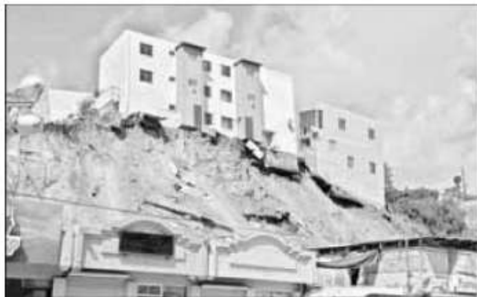
▲ Uno de los dos complejos de departamentos ubicados en el tramo denominado Cuauhtémoc Sur de Tijuana, Baja California. Protección civil municipal informó que en esa ciudad fronteriza hay unas mil 500 casas en riesgo de desplomarse por deslaves y movimientos de tierra. Foto La Jornada Baja California
