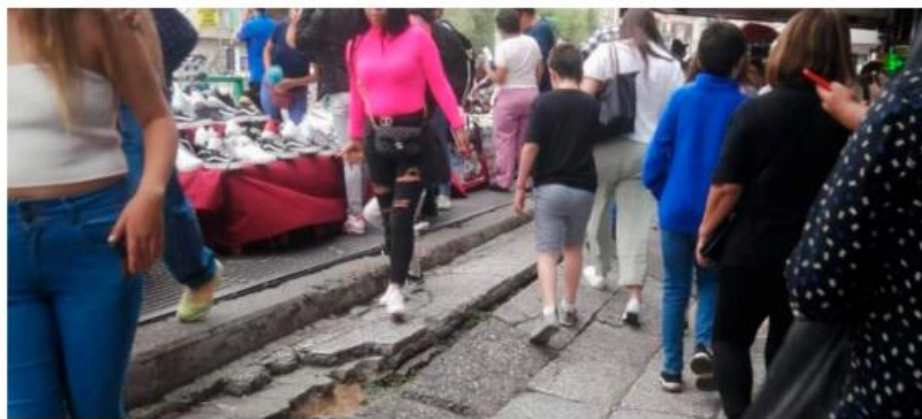
Además de rampas bloqueadas, algunas aceras están tan dañadas que es difícil el tránsito para todas las personas.
