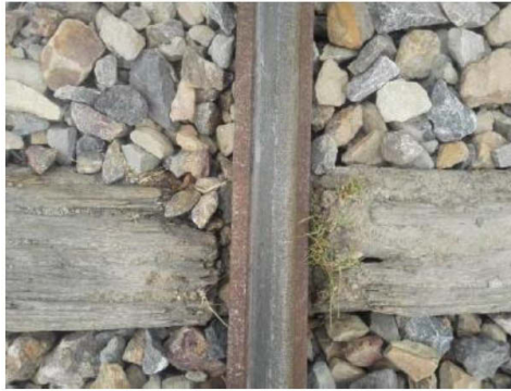
Figura 17 Rompimiento de madera
