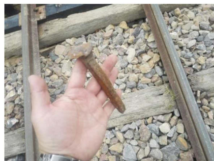
Figura 16 Defecto de no fijación en el durmiente
