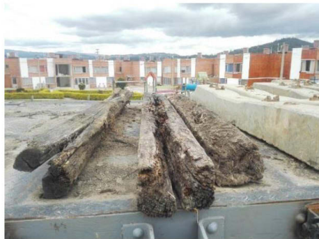
Figura 14 Pudrición del durmiente de madera
