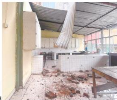
Fotografía cedida por Jorge Luis Martínez, donde se observan los daños causados por un sismo, en el Municipio de Coahuila, Michoacán.
