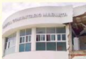
Peligro. El hospital comunitario de Maruata sufrió severos daños.
