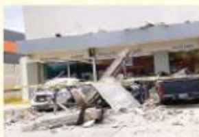
Daños. Esta tienda departamental en Colima está al borde del derrumbe.
